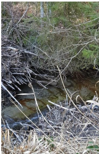
Le barrage est sectionné
